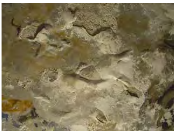
Fig. 3.1 y 3.2 Detalle de las sales solubles, abolsamientos, pulverulencias y manchas en la zona de la cúpula.
