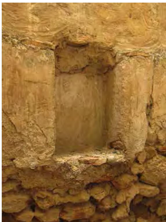
Huecos en paredes.
